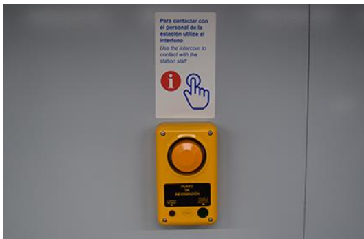
Interfono de estación.
